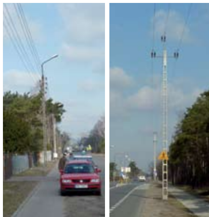
Fot. 7 i 8 Linie napowietrzne 0,4 kV i 15 kV (przewody nieizolowane)
