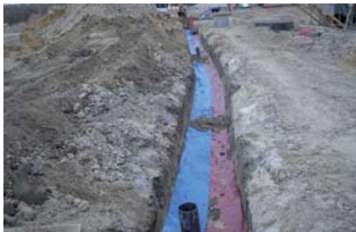
Fot. 4 Kable 0,4 kV i 15 kV oznakowane folią
