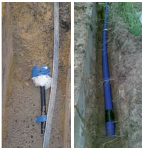
Fot. 1 Kabel 0,4 kV w rurze osłonowej
