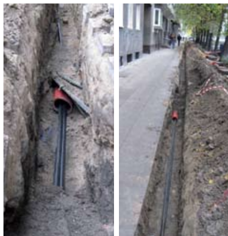
Fot. 2 i 3 Kabel 15 kV w rurze osłonowej
